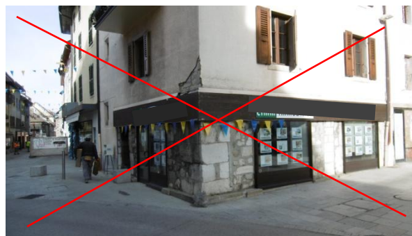
Décalage RDC-façade supérieure
